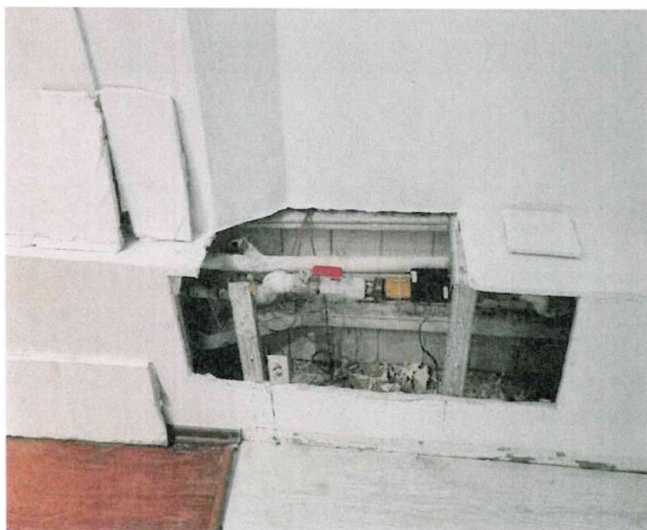
Stav (rozbitý sadrokartón) po sprístupnení merača tepla v hlavnej miestnosti, nutné vyriešiť inou formou prekrytia pre sprístupnenie manipulácie s meračom.
